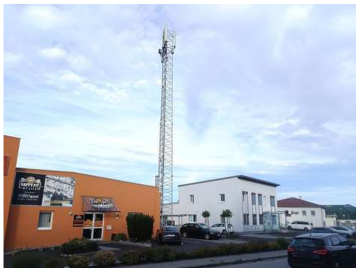
Mobilfunkmasten in der Tragweinerstraße
